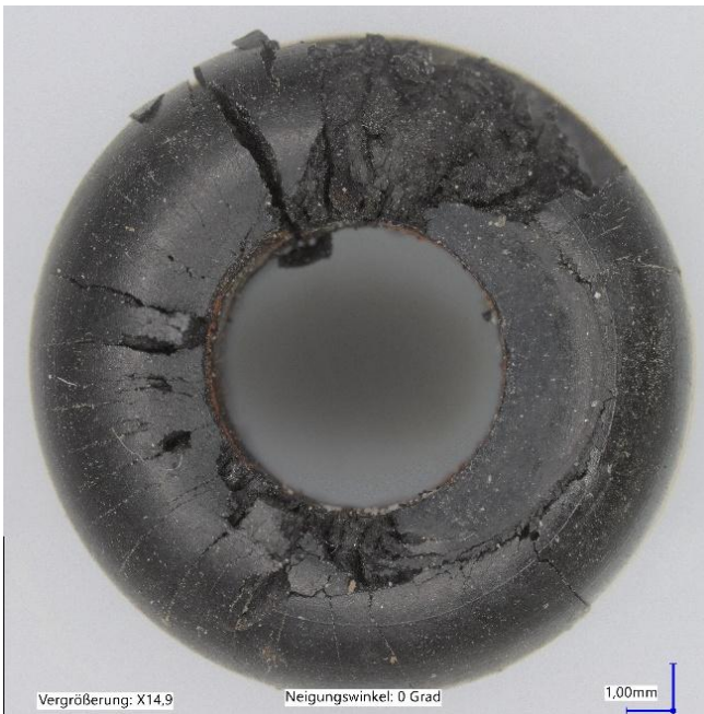
Abb. 1: Hier hat „der Feind in der Luft“, nämlich das Ozon, zu einem Ausfall von einer NBR-Kabeltülle geführt. (Bild: OPR Group GmbH)
