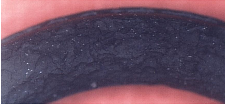
Abb. 3: Geschädigter O-Ring aus einer Hydraulikanwendung: Luft drang in das Elastomer ein und es kam zur Explosiven Dekompression, die zu Abplatzungen an der Oberfläche führte
